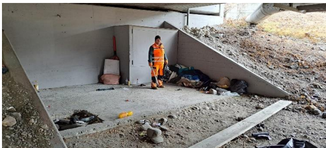
Abb.: Lagerstatt und zahlreiche Abfallgüter unter der Brücke in Landquart.
