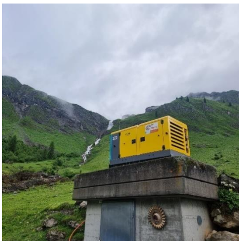
Abb.: Das Notstromaggregat leistete wertvolle Dienste und stellte als «Backup» den laufenden Alpbetrieb sicher.
