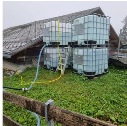
Abb.: Frischwasserbehälter als Überbrückung für das verschmutzte Wasser aus der Quelfassung.
